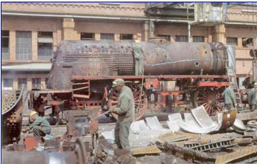
Anfang Juli 1975 ist die Zerlegung von 012 058-4 im AW Braunschweig schon sehr weit vorangeschritten. Sie besaß wie die BR 042 einen vollständig geschweißten Neubaukessel. Gut zu erkennen ist anhand der Stehbolzen das Ausmaß der großen Verbrennungskammer, die mehr feuerberührte Heizfläche zu Lasten der Strahlungsheizfläche schuf. Sie reicht bis an den vorderen Rand der dritten Kuppelachse. Foto: Udo Paulitz
