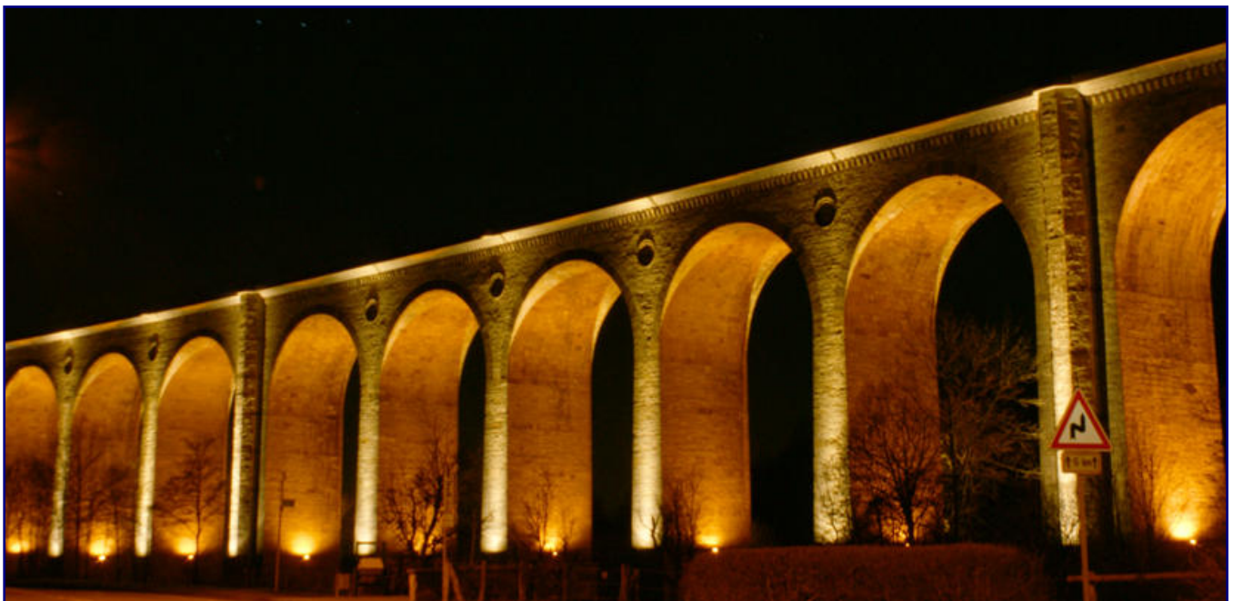
Das Altenbekener Viadukt bei Nacht: Seit jeher ist dieses Bauwerk das Wahrzeichen der ostwestfälisch-lippischen Eisenbahnerstadt.
