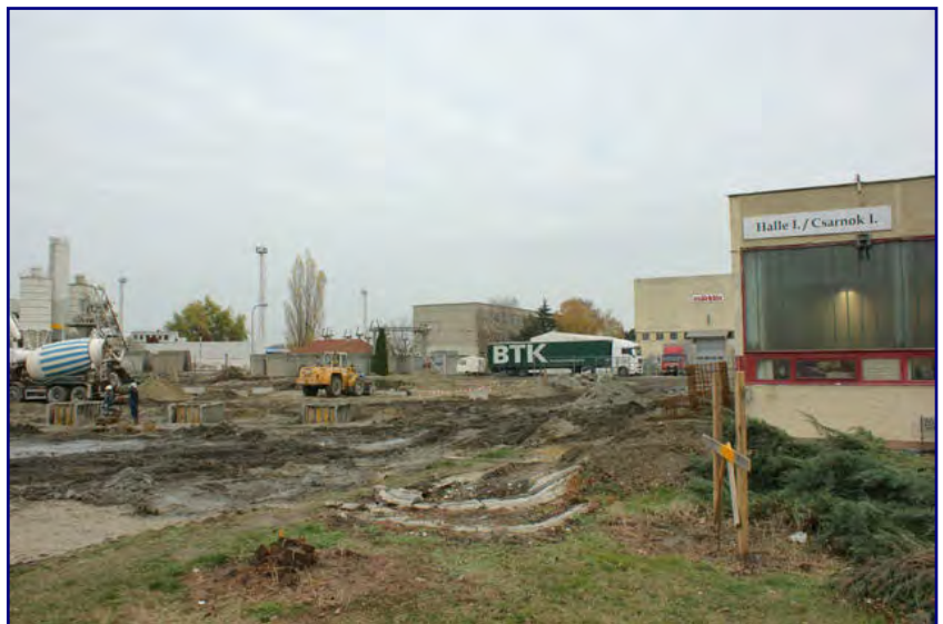
Dank des milden Winters gehen die Bauarbeiten im Märklin-Werk Győr gut voran. Mitte November waren bereits die Fundamente für die neue Halle weitgehend gegossen. Inzwischen steht der Rohbau und wartet auf den Fenstereinbau.
