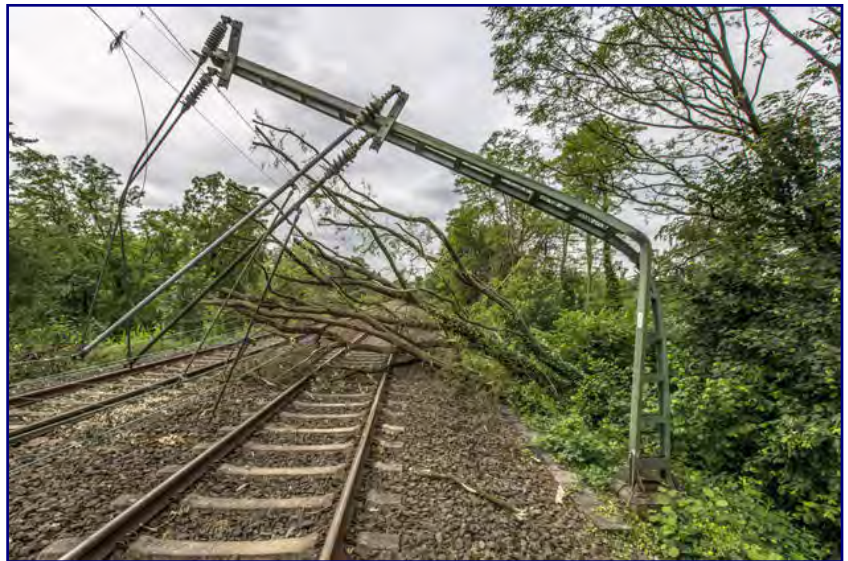
Das schwere Unwetter vom Pfingstmontag 2014 machte der Bahn in Nordrhein-Westfalen, hier an der S6 Düsseldorf - Essen bei Ratingen-Ost, zu schaffen. Kritiker sehen jedoch auch eine Mitschuld der DB an den Schäden durch umgefallene Bäume. Deren hinreichender Zuschnitt zur Wahrung der Profillfreiheit gehört zu den Erhaltungsarbeiten an der Infrastruktur. Foto: Deutsche Bahn AG/Michael Neuhaus
