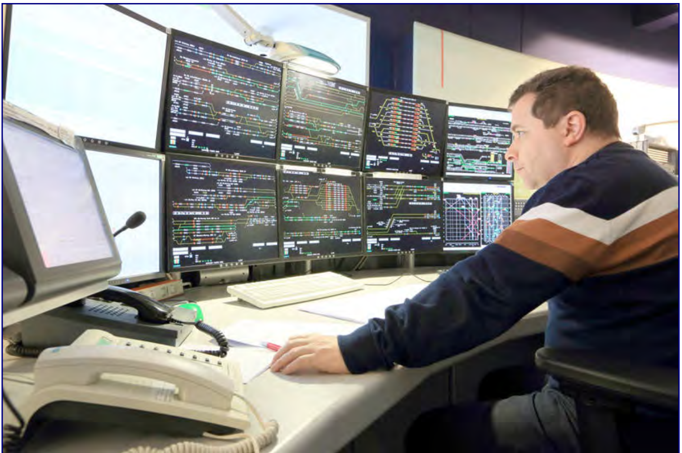
Ein Blick in die Betriebszentrale München: Der Fahrdienstleiter des Elektronischen Stellwerks (ESTW) München-Pasing steuert und überwacht den Betriebsablauf des Fern-, Nah-, Güter- und S-Bahnverkehrs in seinem Bereich. Foto: Deutsche Bahn AG/Uwe Mieth
